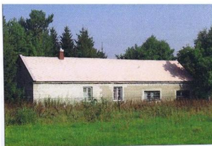
Fot. 6 Przykładowy obiekt z III stopniem pilności (płyty „karo” zabezpieczone powłoką malarską)
