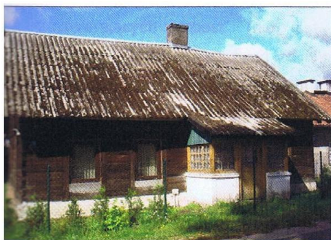
Fot.3 Przykładowy obiekt z II stopniem pilności (struktura pokrycia naruszona przez mech)
