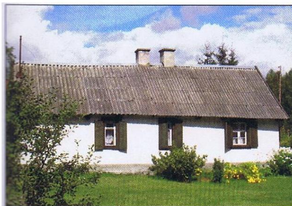
Fot. 1 Płyty azbestowo-cementowe faliste
