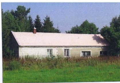
Fot. 6 Przykładowy obiekt z III stopniem pilności (płyty „karo” zabezpieczone powłoką malarską)
